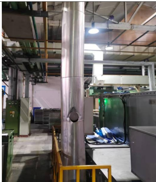
曲轴箱废气处理设施
