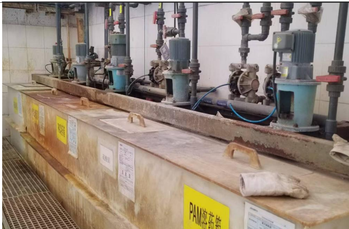
污水处理设施
