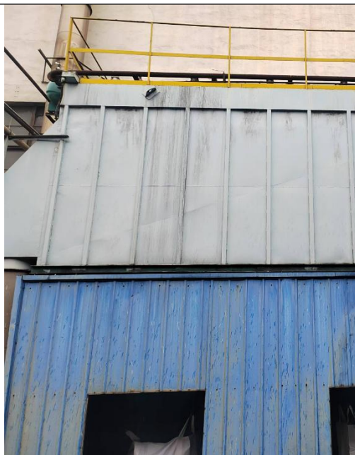
混砂废气处理设施
