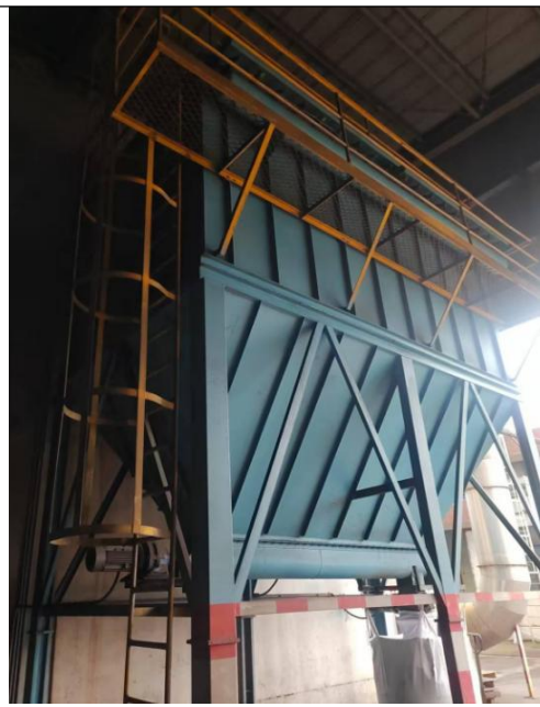
落砂废气处理设施
