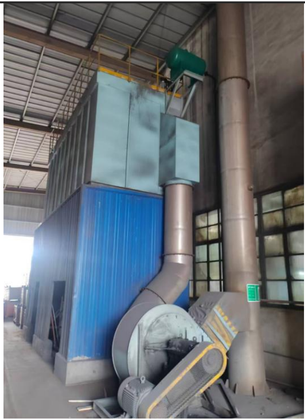
落砂废气处理设施
